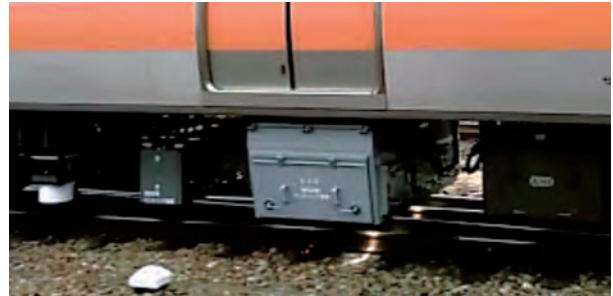
● 測定中のモニタリング装置 ●
